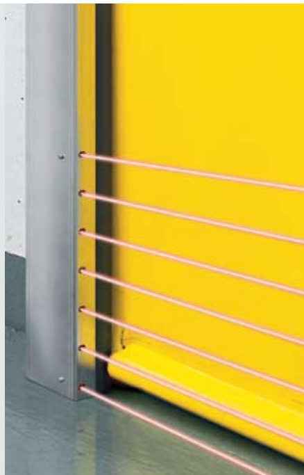
Valopuomi piiloasennettuna ovijohteisiin.
