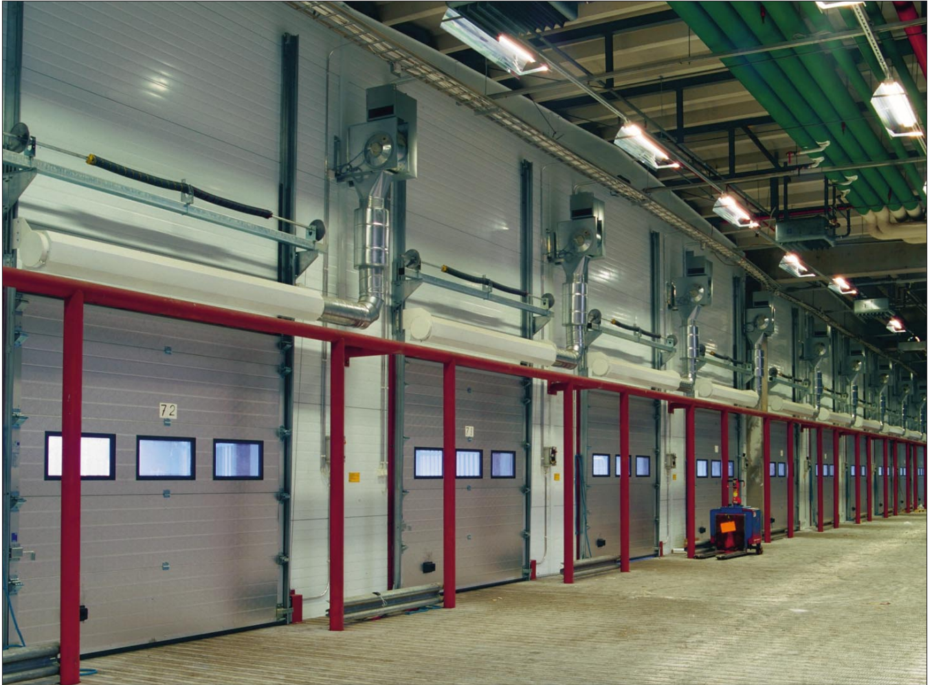
Inex Partners Oy, Kilon logistiikkakeskus. Kuvassa olevat ovet voivat kaikki olla yhtäaikaan auki niiden kuitenkaan aiheuttamatta vetoa sisätiloihin. Mesvac-ilmasulut vähentävät vedon aiheuttamia terveysriskejä, elintarvikkeiden pilaantumista ja energiahävikkiä.
